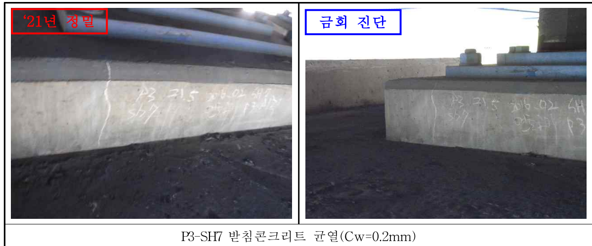
&lt;표 3.12&gt; 교량받침 외관조사 결과
