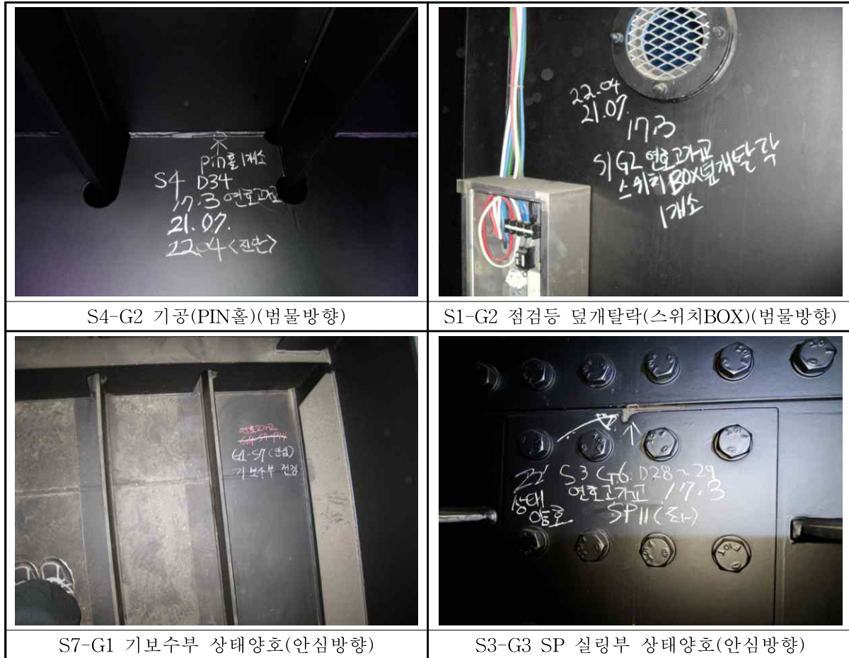
&lt;표 3.3&gt; 거더 내부 외관조사 결과
