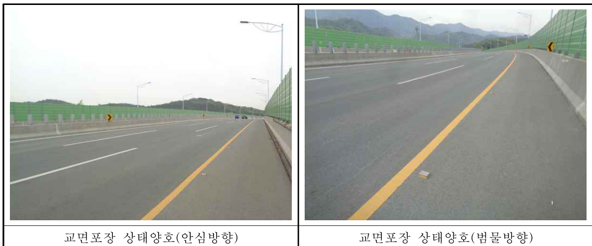
<표 3.22> 교면포장 외관조사 결과
